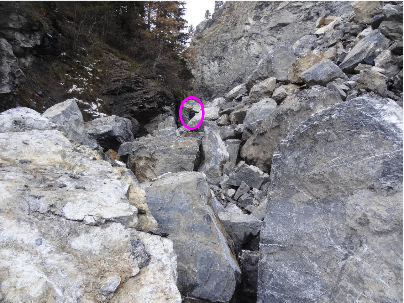
Photo 6 : Chaos de blocs dans la partie supérieure en décembre 2013.
